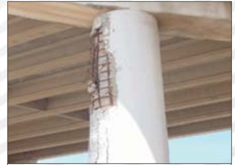
Pilt: Näide terasarmatuuri korrosioonist põhjustatud „betooni mahakoorem“ silla külgedel.
